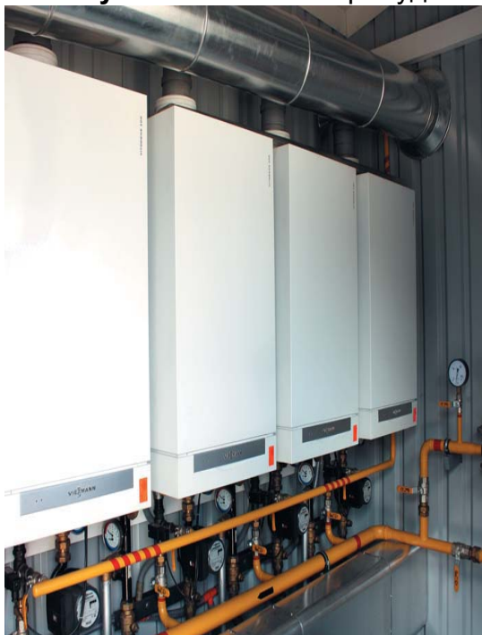
Рисунок 1.1. Типова прибудинкова котельня
